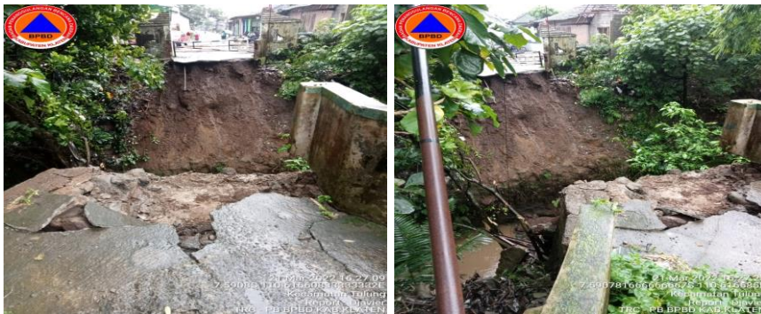
Foto kerusakan jembatan penghubung 3 Dukuh di Desa Tulung akibat longsor di Tegal Srimulyo
