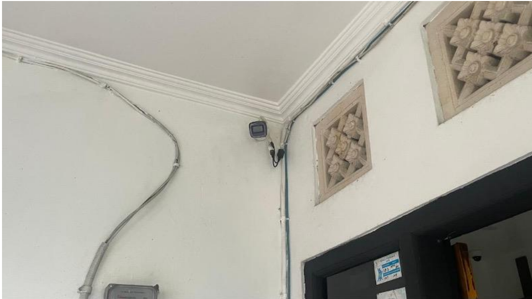
IP CCTV yang akan dipakai untuk penelitian.
